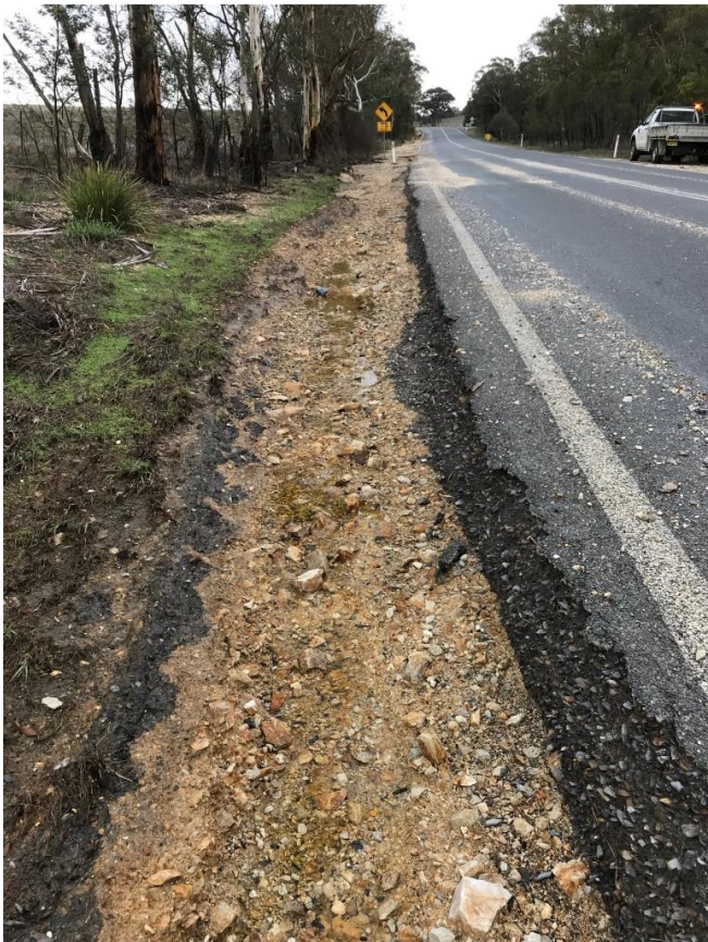
2107 Bungedore Rd - shoulder scour
