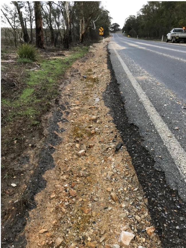
2107 Bungedore Rd - shoulder scour
